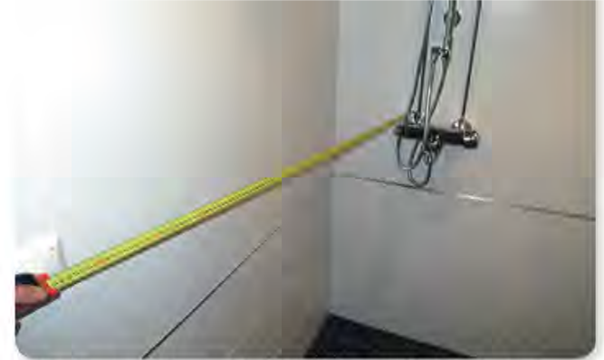
Tarkastettavana pesuhuoneen valokatkaisijan turvateisyydet suhkusekoittajasta.
